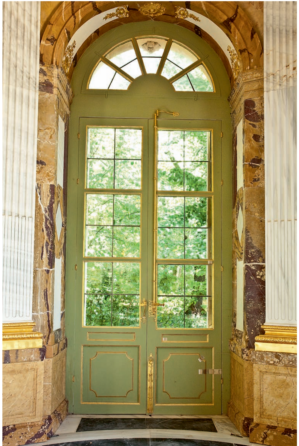
Fig. 14. Una de las puertas vidrieras. El color verde original (de 1733) ha sido recuperado en la restauración; en la cata realizada en la parte inferior derecha se aprecia la estratificación de las intervenciones posteriores.
