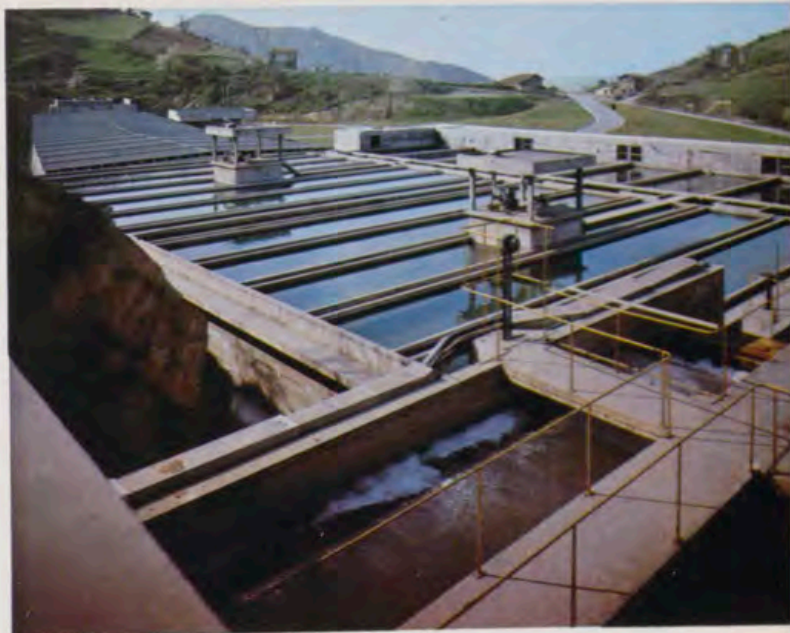
Estación depuradora de aguas de Venta Alta.
