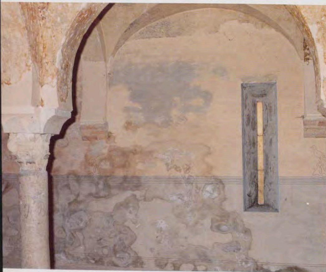
Muro oeste del Cuarto Templado. Efectos de la humedad.
