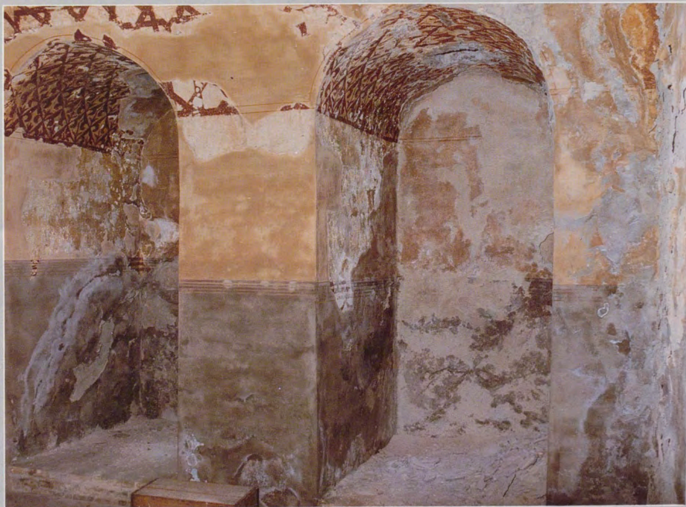
Cuarto frío. Estado en que quedaron los vestidores tras la inundación.
