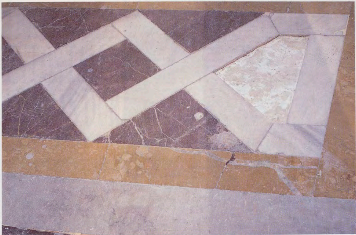
Un detalle del pavimento durante la restauración, que permite advertir cómo el delgado mosaico de mármol está asentado sobre losas de Colmenar.
