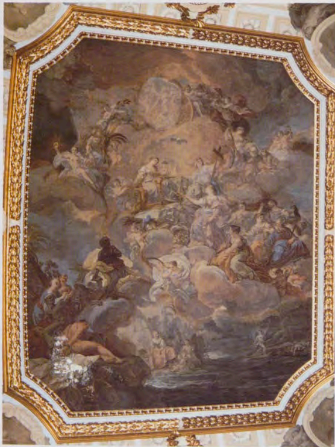
Escalera Principal. «Triunfo de la Religión y la Iglesia». Destaca en la parte superior una amplia zona afectada por una gotera.
