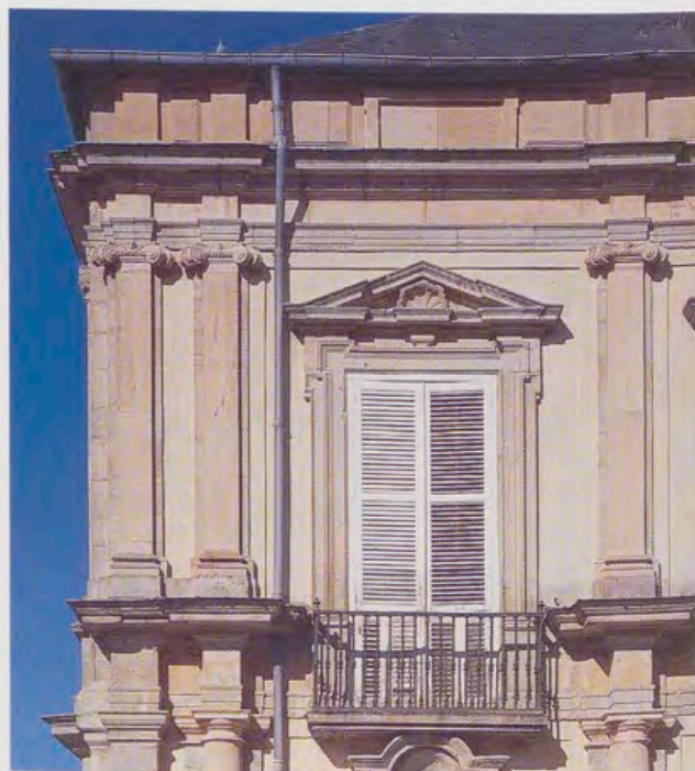
Andrea Procaccini, Detalle de la fachada a los Jardines en el ala suoriental.
