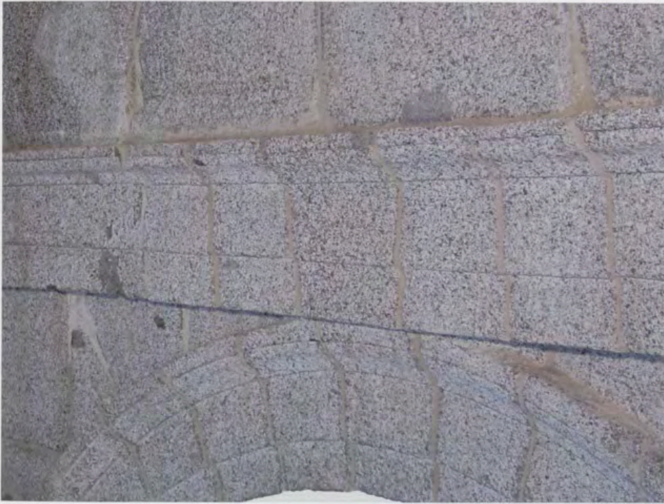
Fig. 8. Limpieza del granito y eliminación de sales, 2009, Fotografía: Dirección del Patrimonio Arquitectónico e Inmuebles, Patrimonio Nacional.
