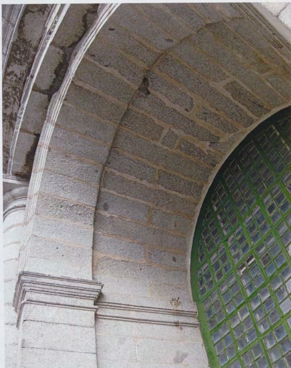
Fig. 10. Detalle de la carpintería de ventanal del tambor antes de la restauración, 2008, Fotografía: Dirección del Patrimonio Arquitectónico e Inmuebles, Patrimonio Nacional.
